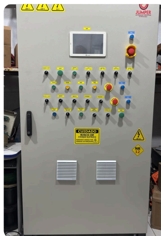
Painel de automação montado pela Jumper
