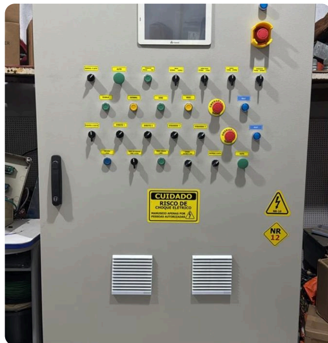
Painel de automação montado pela Jumper.
